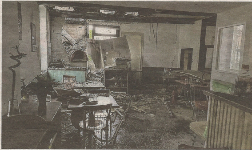
Le plafond de l'établissement s'est totalement affaissé au niveau du four. DR
